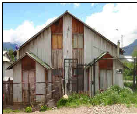
Deficiente aislación térmica en viviendas
