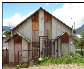
Deficiente aislación térmica en viviendas
